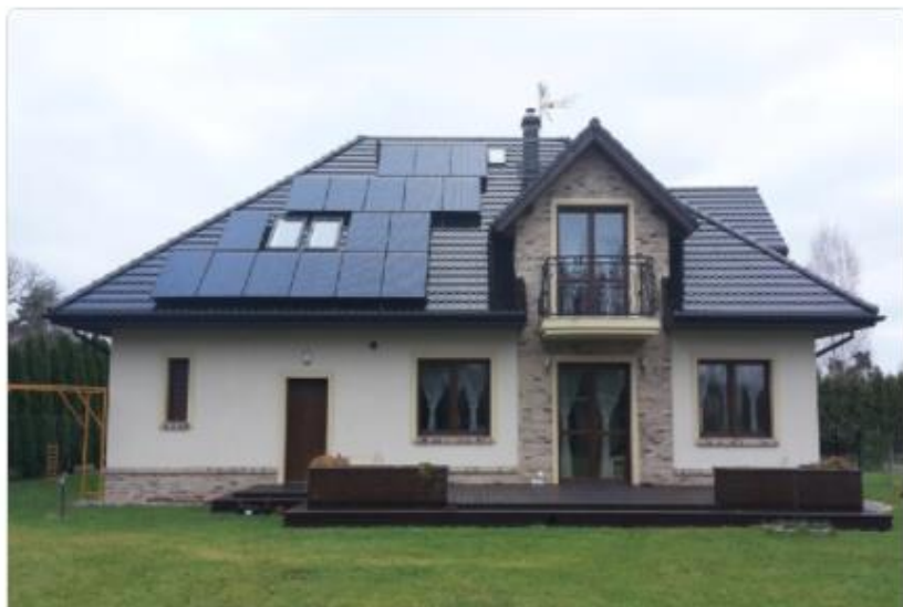
Instalacja fotowoltaiczna ~ 7000 kWh
